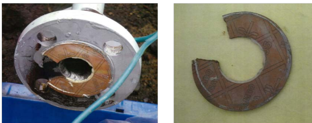
図-3 破損したガスケット写真
