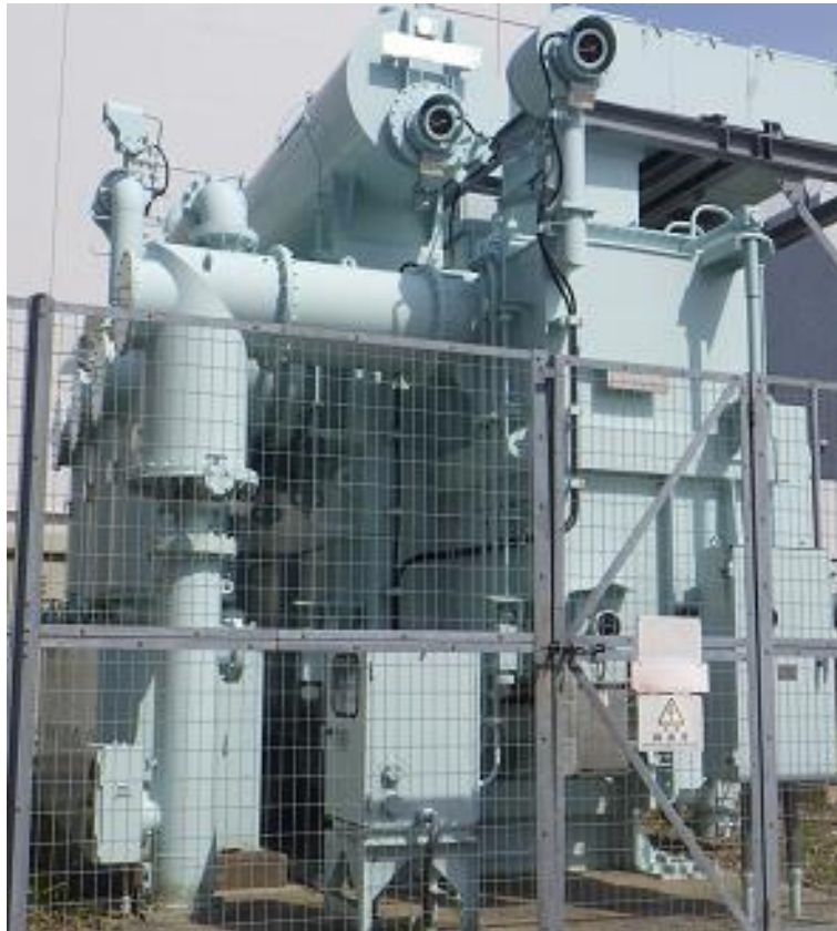
【変圧器外観（当社主変圧器）】
