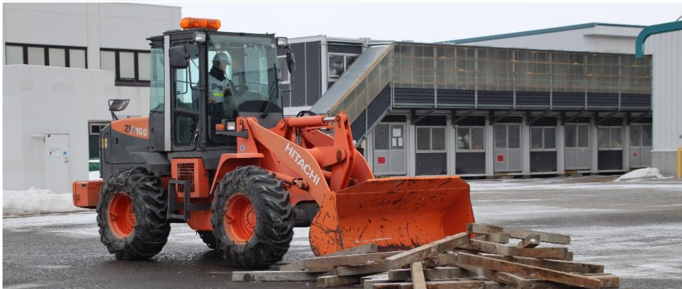
地震により落下したがれきを当社のホイールローダを使用して取り除き、電源車の走行ルートを確認します
