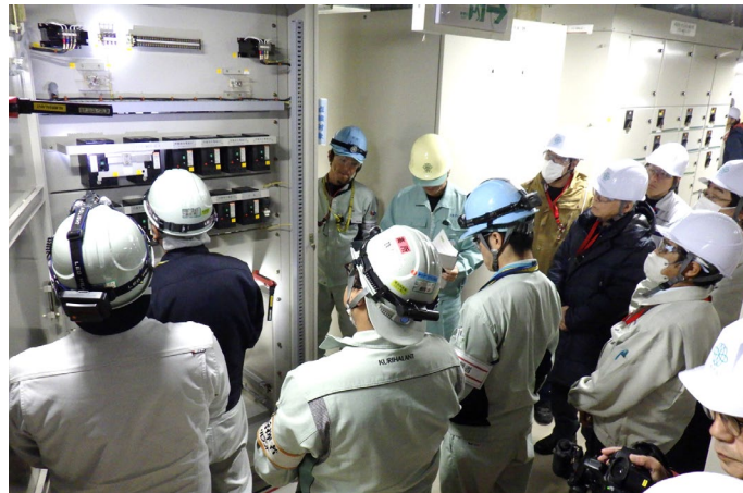
分電盤の点検を見学
