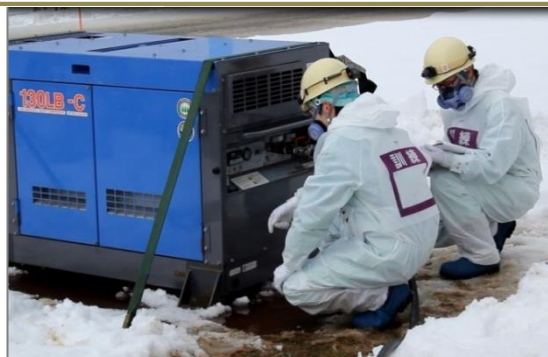
可搬型空気圧縮機の接続訓練
