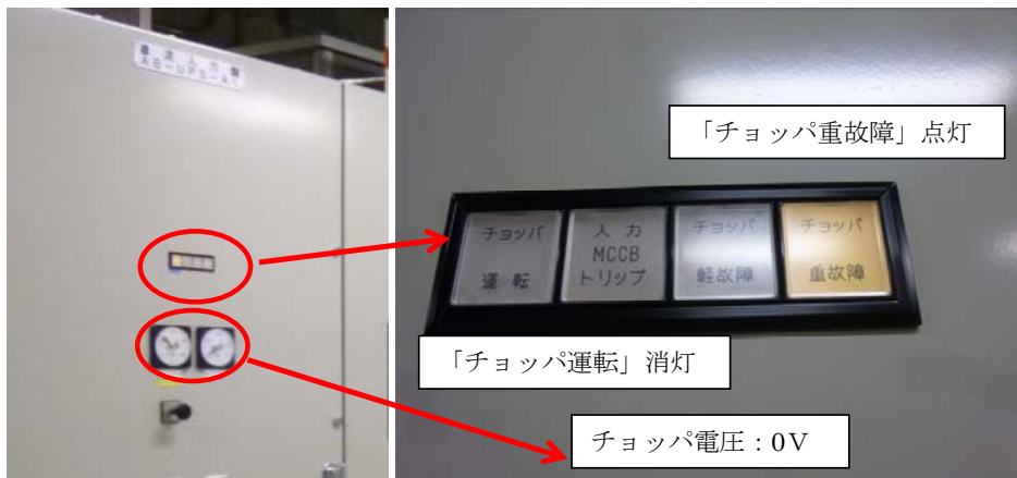
図3 現場盤 警報表示窓等の確認
