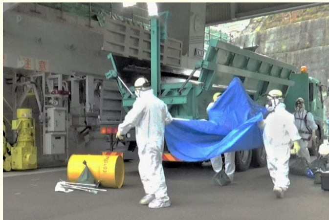
落下した廃棄体をシートで養生する様子
