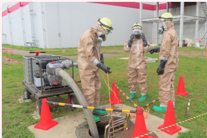
防護服を装着した消火班が屋上散水に使用する水を汲み上げるポンプを設置する様子
