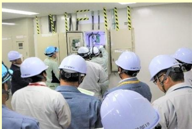
③ 受信機の動作確認をしている様子
