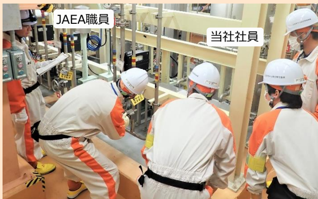
脱硝設備の運転操作の指導を受ける様子
