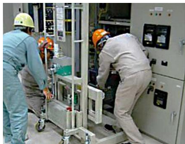
配電盤の点検訓練
