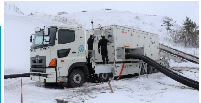
大型移送ポンプ車により送水する様子
