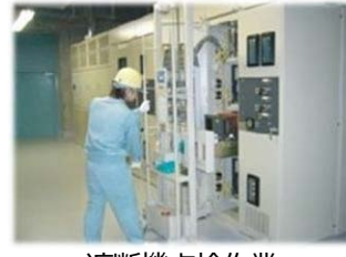
遮断機点検作業
