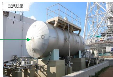
①硝酸ヒドラジン受入れ貯槽 (屋外・地上)
