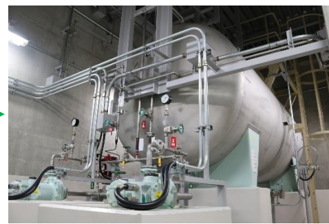
③TBP受入れ貯槽 (試薬建屋内・地上)
