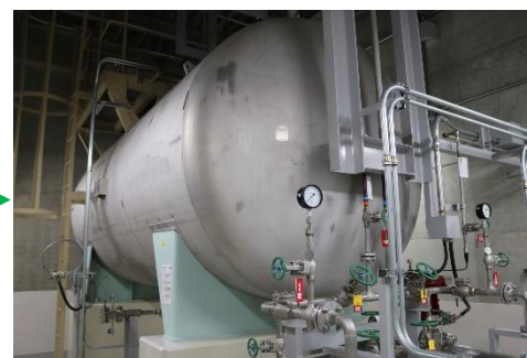
②n-ドデカン受入れ貯槽 (試薬建屋内・地上)
