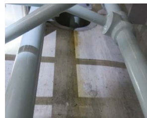
9/22 撮影 漏えい痕
