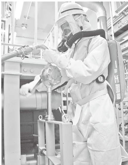
現場に到着した運転員が、事故収束のための薬剤を手動供給
