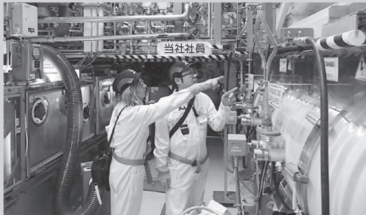
設備の稼働状況を確認
