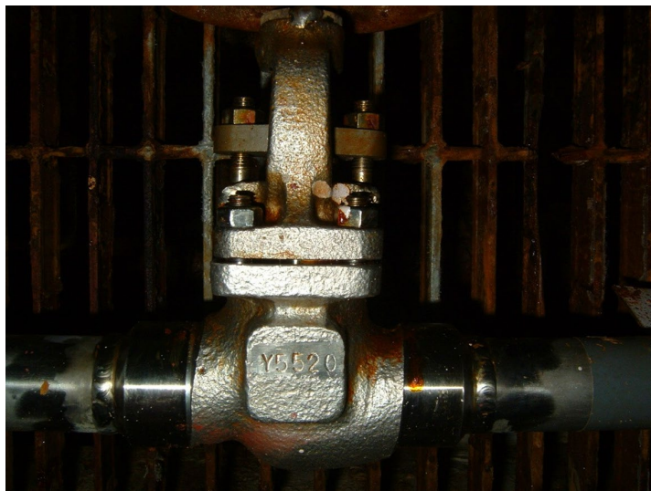
【漏えい弁の状況】
