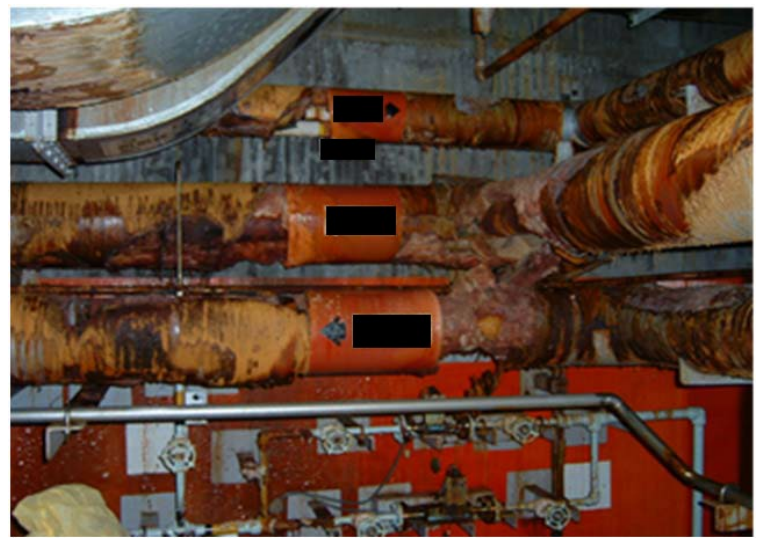
【漏えい時の設備状況】
