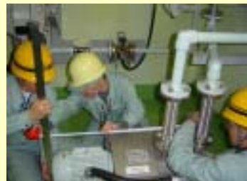
現品点検 ポンプの寸法を測定している様子
