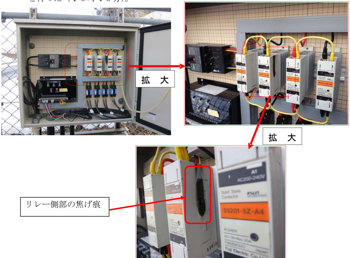
図-3 制御盤内の目視点検時の状況
