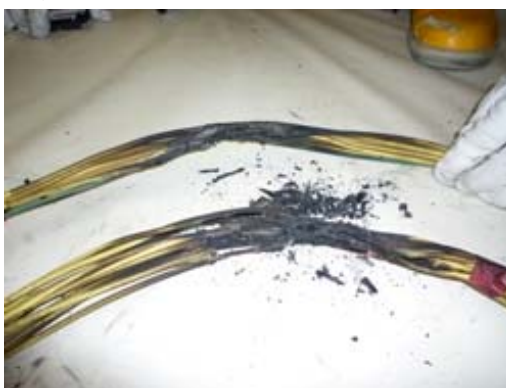
焼損し、熔断した電線
