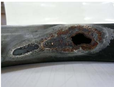
焼損した電線管
