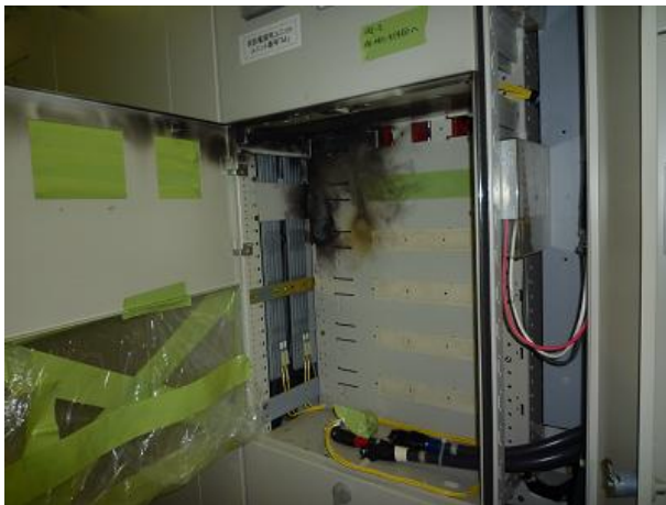
ハル・エンドピース貯蔵建屋 460V コントロールセンタ D 2 ( 6 E ) 盤内
