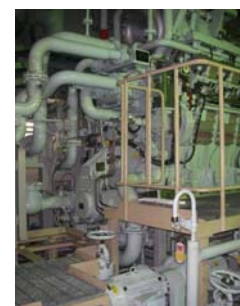
(非常用ディーゼル発電機)
