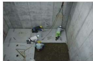
③ピットの底版部に集水機能 のあるコンクリートを据付
