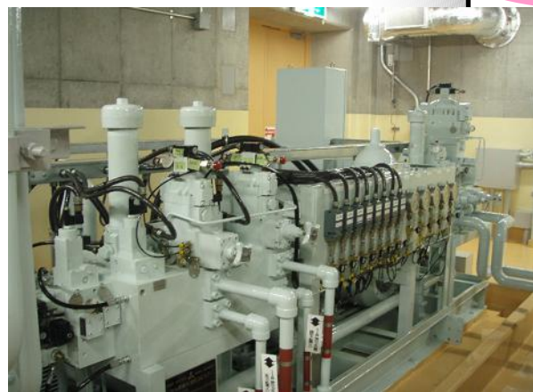
油圧制御ユニット全景(矢視A)
