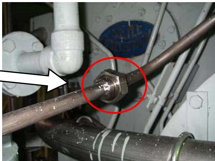
潤滑油漏えい箇所
