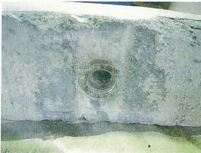
図-3-4 ねじ込み部確認状況
