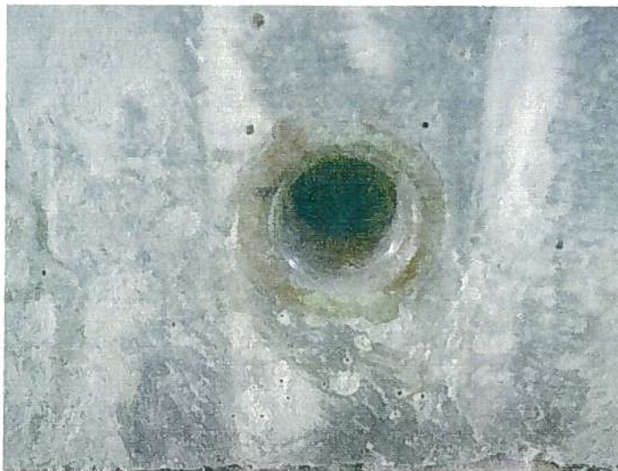
図-3-1 ねじ込み部確認状況
