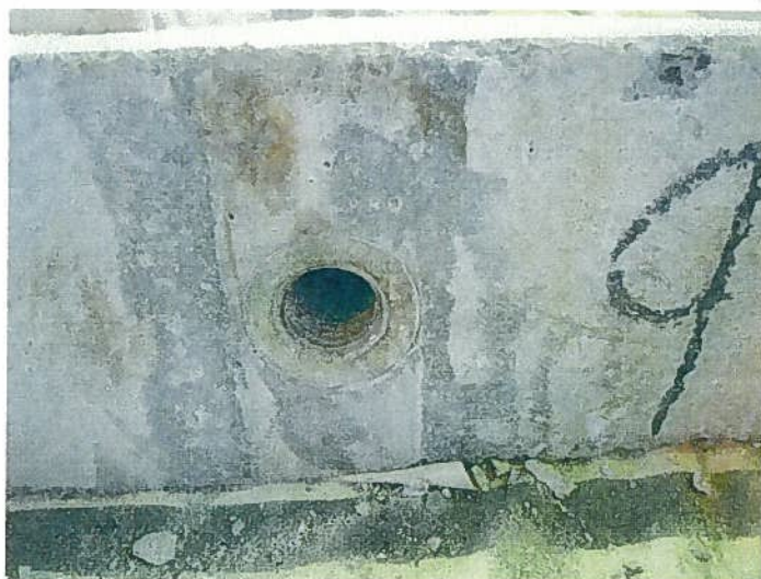
図-3-3 ねじ込み部確認状況
