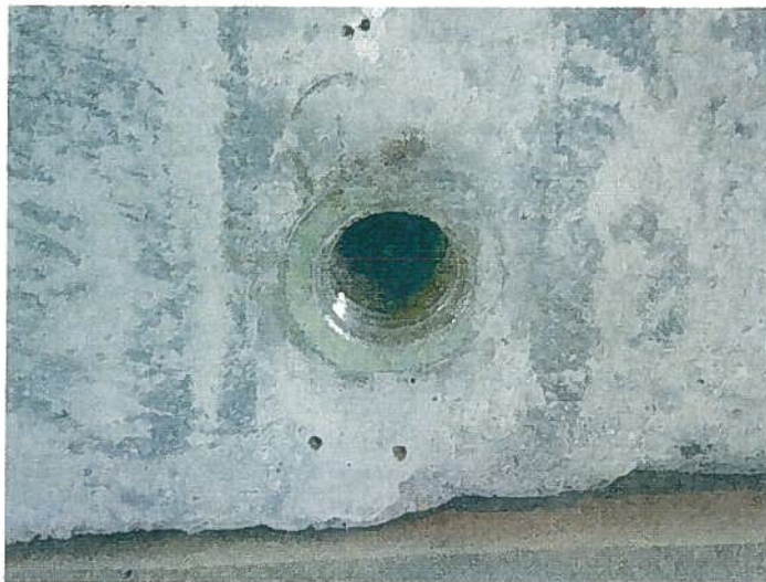
図-3-2 ねじ込み部確認状況
