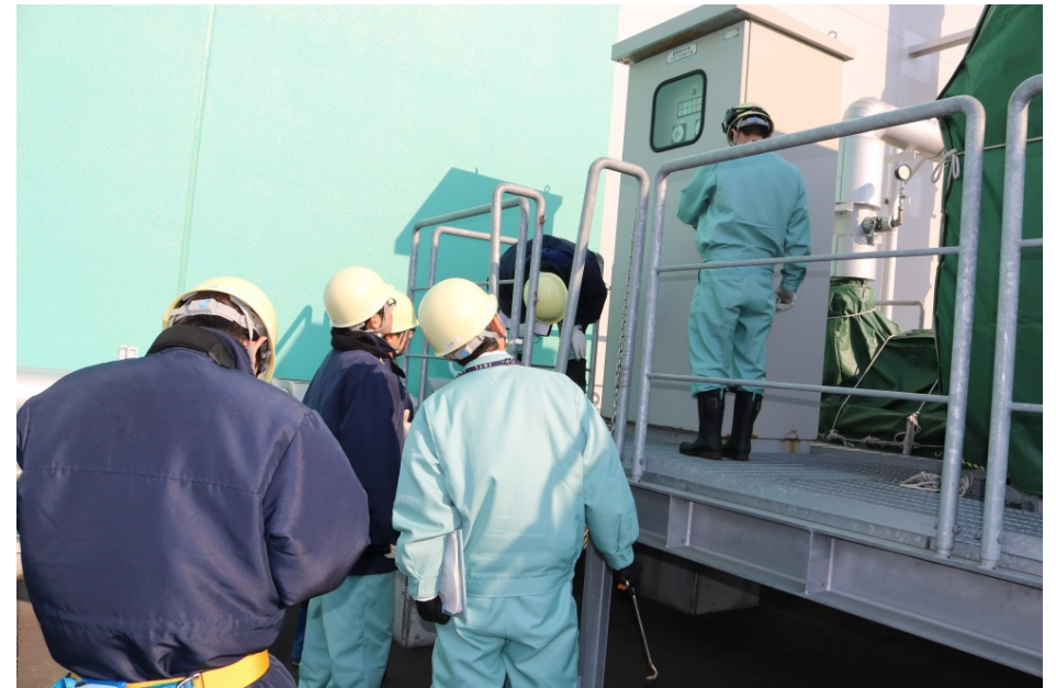
操作盤の確認
