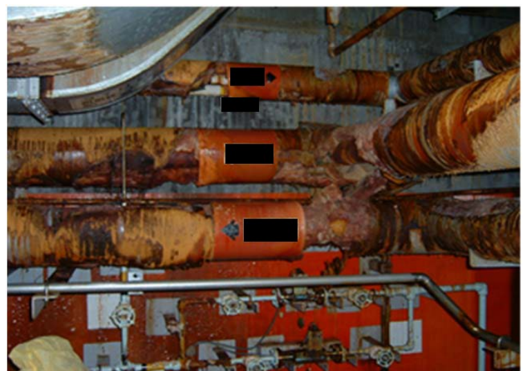
【漏えい時の設備状況】
